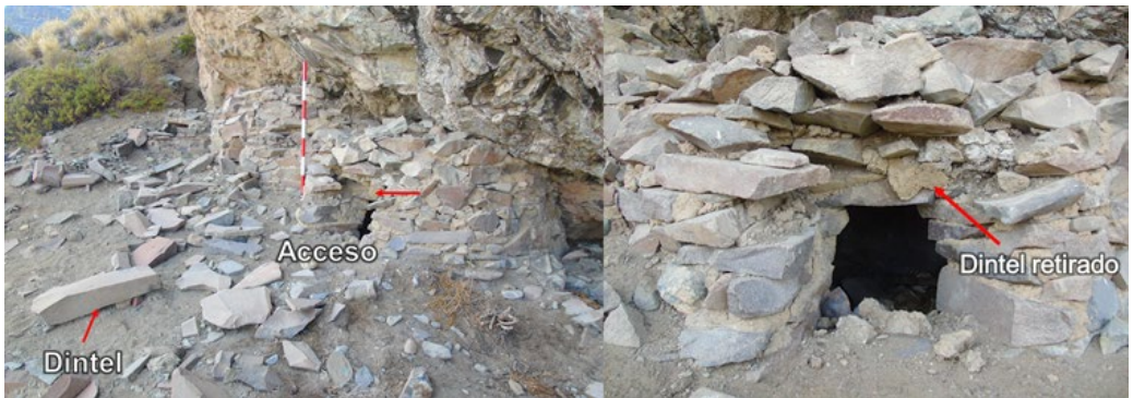
Figura 04: Ambiente 2 en el sitio Gentilmach'ay, se evidencia el retiro del dintel por parte de los saqueadores con la finalidad de facilitar el acceso.
